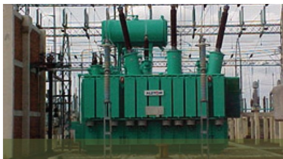
Figura 3 Subestación eléctrica reductora
