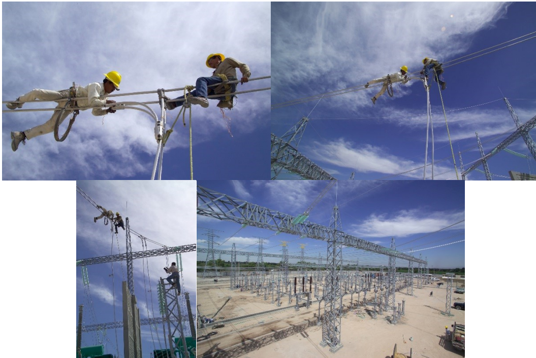
Figura 26 Bus flexible de dos conductores en paralelo por fase
