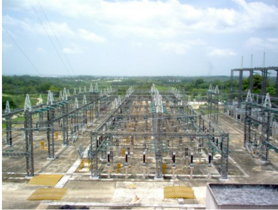
Figura 4 Subestación eléctrica de Maniobra.
