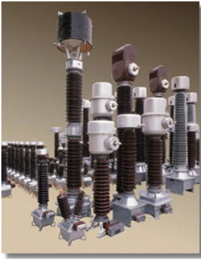
Figura 14 Transformadores de potencial y de corriente
