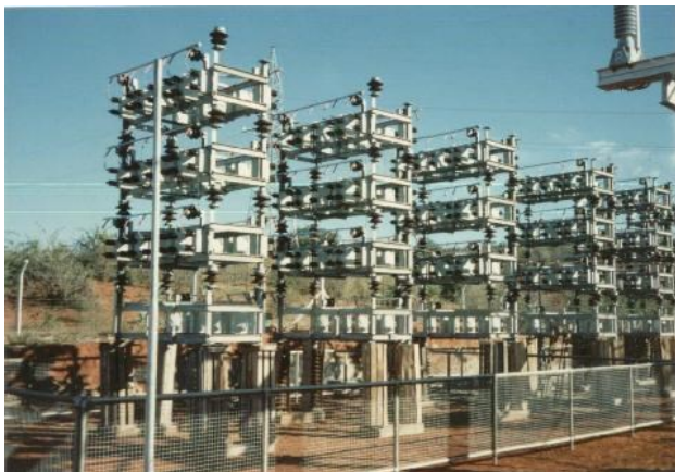
Figura 15 Banco de capacitores paralelo
