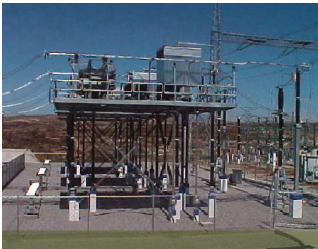
Figura 14 Banco de Capacitores Serie
