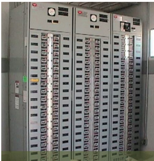
Figura 16 Tablero de servicios propios
