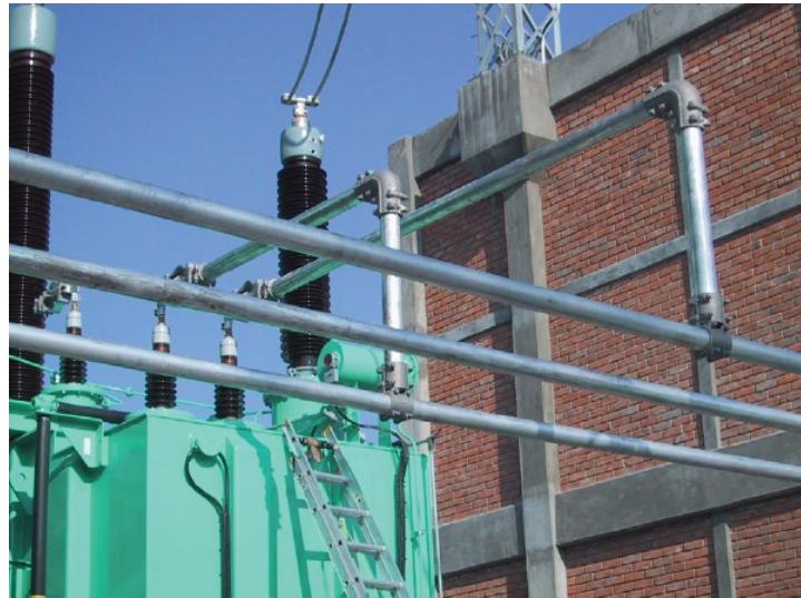
Figura 27 Bus rígido de un conductor por fase
