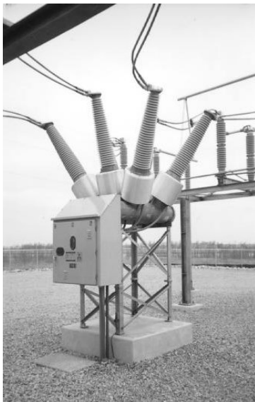
Figura 23 Interruptor de tanque muerto
