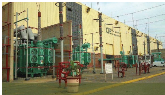
Figura 2 Subestación eléctrica elevadora
